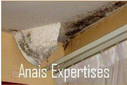
Moisissures liée à la présence d'une condensation excessive d'humidité
