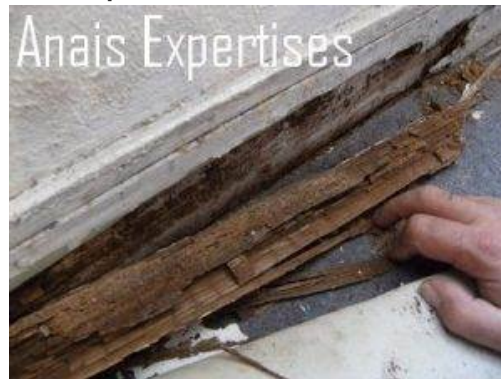
Pourriture cubique liée à la présence d'un mэрule
